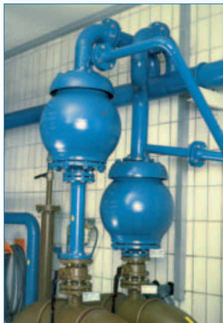
Be- und Entlüftungsventil für Abwasser
